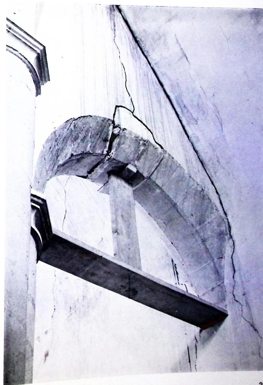
Bas - côté sud - Rupture d'équilibre des matériaux, causée par l'affouillement du sol.
